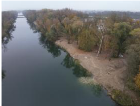
Nachher: Der Lechabschnitt oberhalb der Lechbrücke B16 mit den abgeflachten Ufern und eingebauten Strukturelementen.
