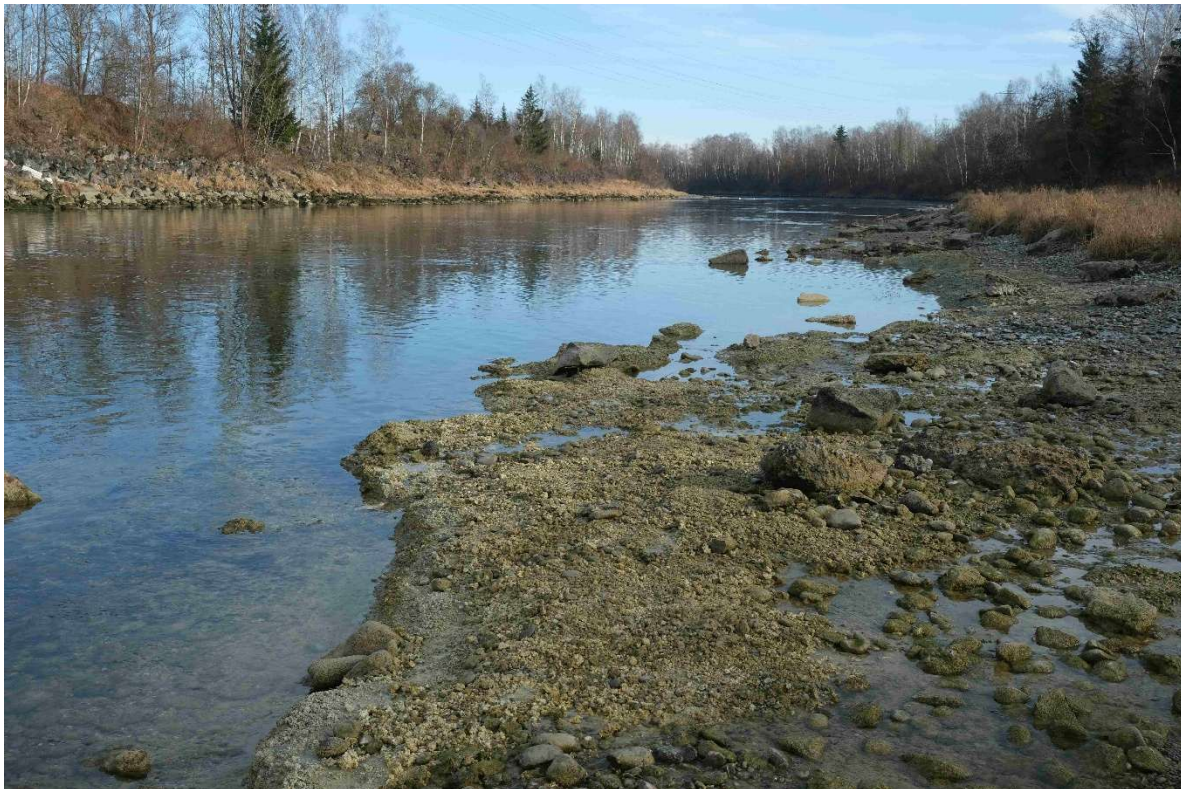
Fotos: Aktuelle Verflinzungen (d.h. Freilegung der Flußsohle, die sog. Flinzschicht, durch Kiesabtrag in Folge von wasserbaulichen Maßnahmen) bei Flußkilometer 46,2, 46,5 und 50,4 © Dr. Eberhard Pfeuffer
